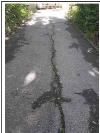
Brüchiger Asphalt am Weg
