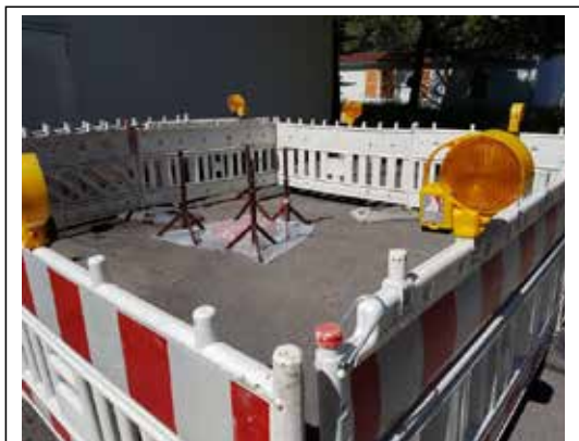
Eingebrochener Asphalt bei Haus 10 – mittlerweile gesichert und abgesperrt
