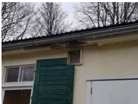
Putzschäden an Haus 1
